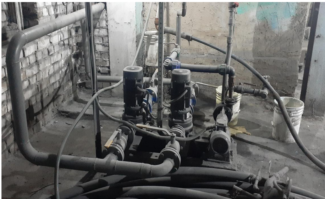
Рис.4. Насосная группа котельной
